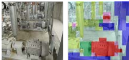
モーターの稼働状況監視
